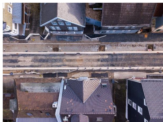
Luftbild von der Baustelle Bahnhofstraße Foto: Tim Vogel (Bird's Vision – Petri & Vogel GbR)
